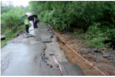
Droga zniszczona w czasie nawałnicy.
